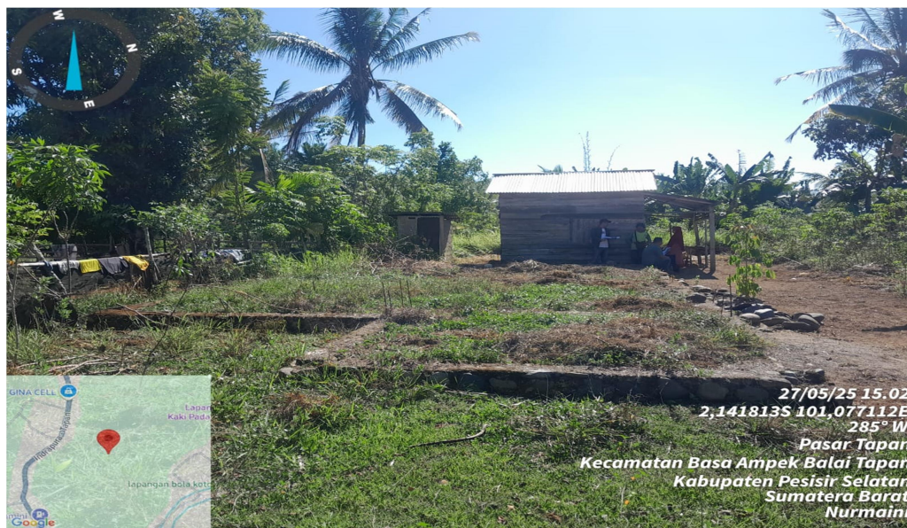
Gambar 3.8 : Kondisi Rumah Tidak Layak Huni (Sebelum dilakukan Rehabilitasi)
