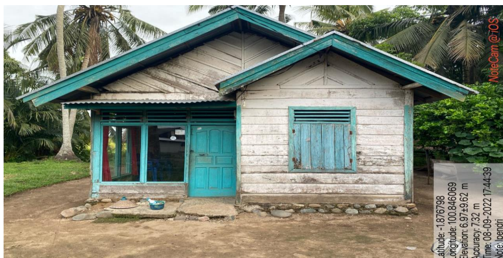
Rumah Tidak Layak Huni (Sebelum di rehabilitasi)
