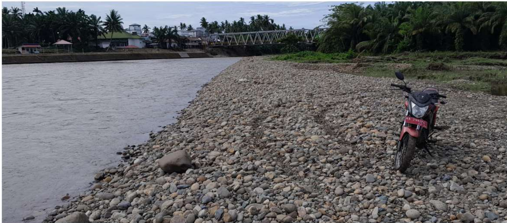
Tanggul Batang Inderapura Abrasi Akibat Gerusan Arus Sungai
