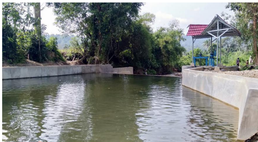
Gambar 2.12 : Bendung DI. Sawah Rumah Gadang (2021)
