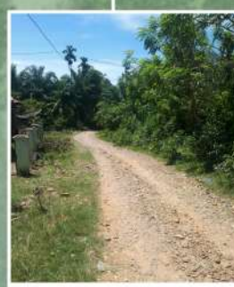
4. Jalan Kerikil Rusak
