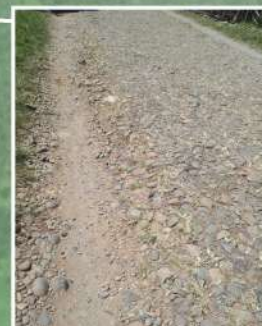
3. Jalan Kerikil Rusak
