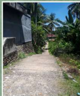
6. Jalan Beton Rusak
