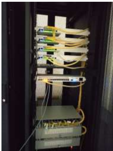
Server Jaringan Internet/Intranet Pemkab Pesisir Selatan di Dinas Kominfo
