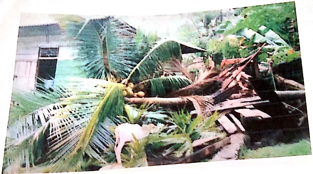
DOKUMENTASI KEADAAN RUMAH ELISMAN / ENI ROSVITA AKIBAT TERTIMPA POHON KELAPA TANGGAL 28 AGUSTUS 2017 DI KAMPUNG SUNGAI SIRAH NAGARI SURANTIH KECAMATAN SUTERA
